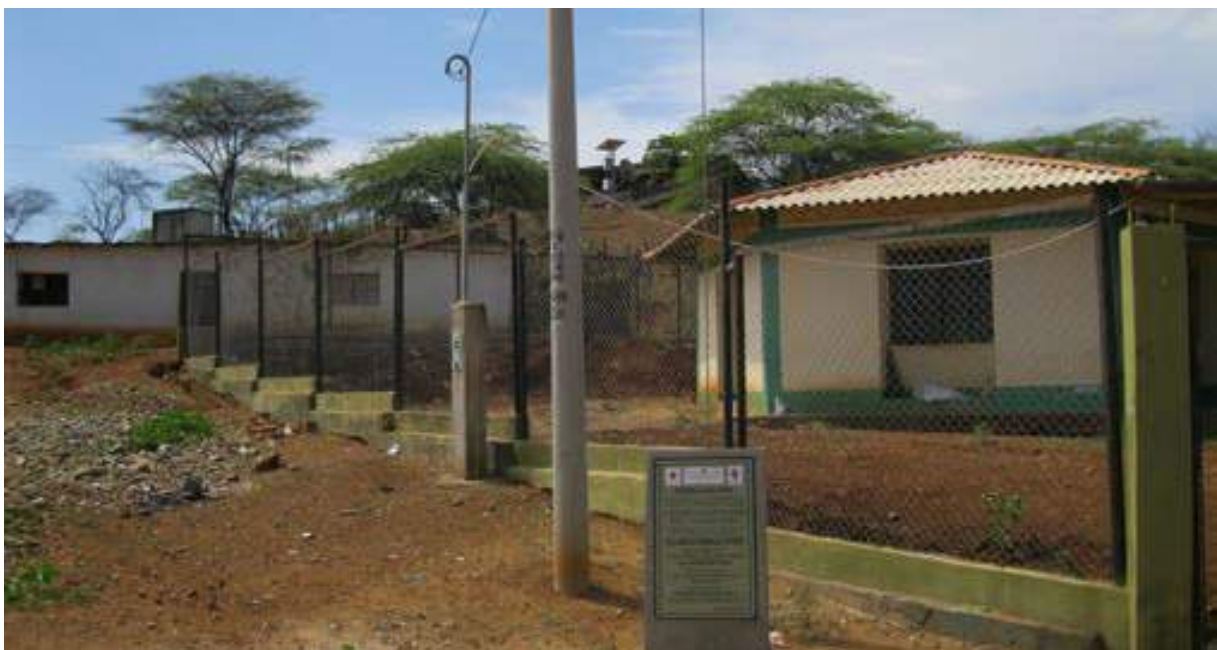
Interconexión eléctrica vecinal en Suyo, Ayabaca, Piura financiada por el Gran Ducado de Luxemburgo y el Ministerio de Energía y Minas
