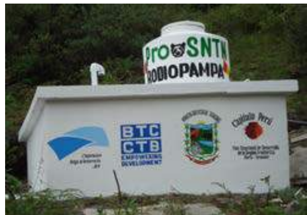
Reservorio con clorador y captación de agua de Rodiopampa. Tabaconas, San Ignacio, Cajamarca.
