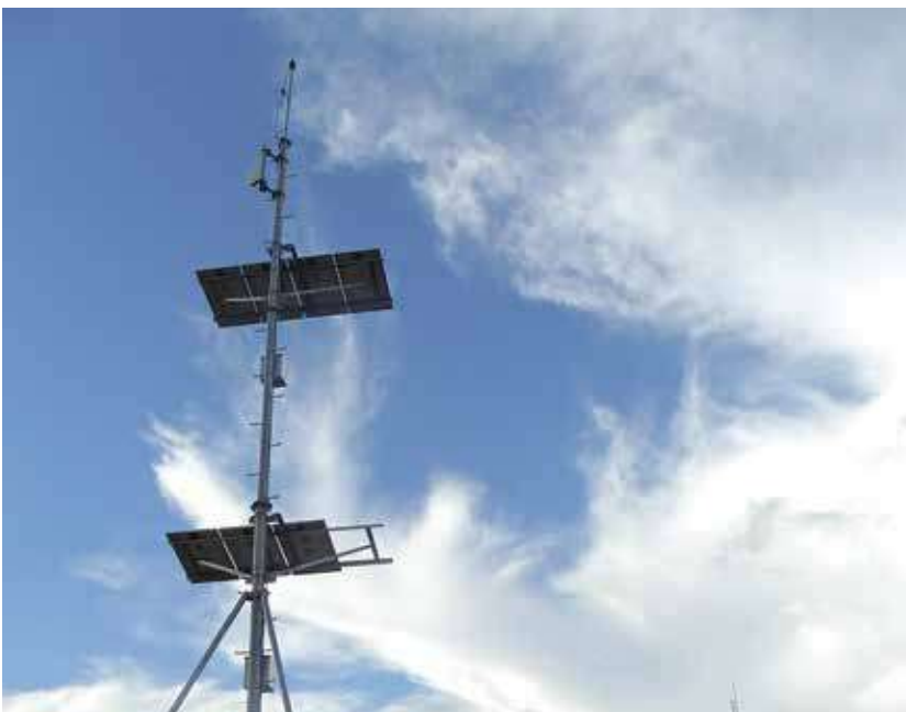
Instalaciones de comunicaciones en localidad fronteriza
