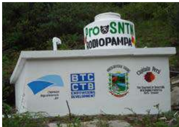
Reservorio con clorador y captación de agua de Rodiopampa. Tabaconas, San Ignacio, Cajamarca.
